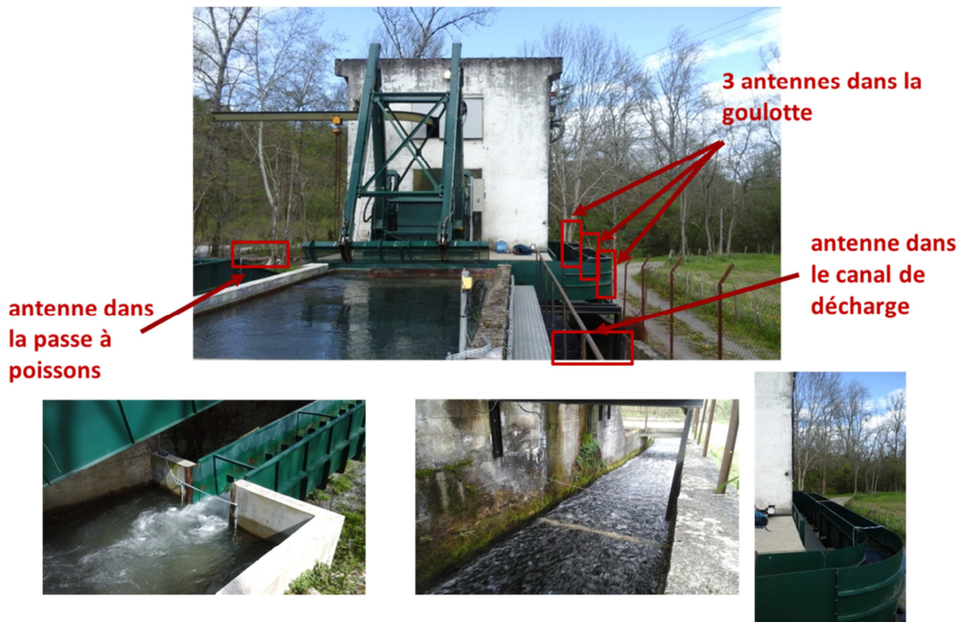
Figure 14 : Photos de la centrale à Trois-Villes avec l'emplacement des antennes RFID.
