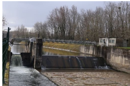
Photo 12. Vue aval de l'exutoire (à gauche) et de la vanne-toit (à droite)
