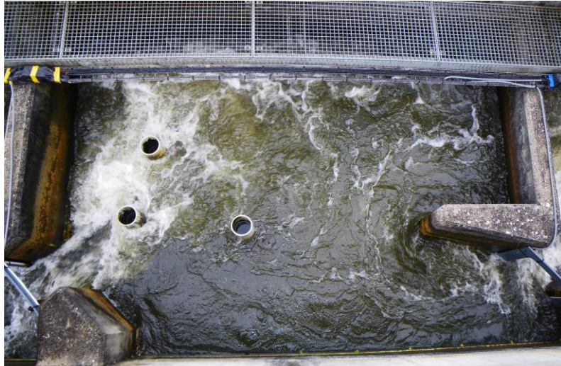
Figure 4 : Bassin équipé de trois cylindres disposés en triangle.
