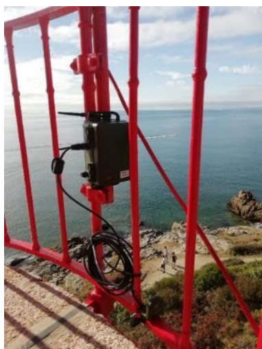
Figure 1 : Batcorder SM4 installé sur le phare de Port Manec'h (©Emmanuelle Cabon – Phares & Balises)
