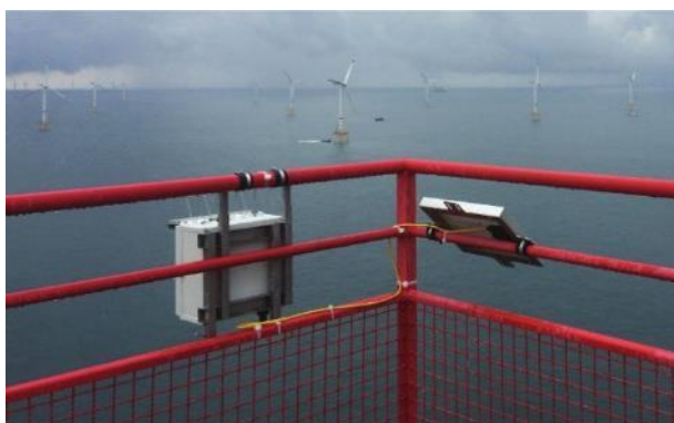
Figure 2 : Batcorder installé sur la plateforme de treillage pour hélicoptère à l'arrière de la nacelle d'une éolienne (Brabant et al., 2020)
