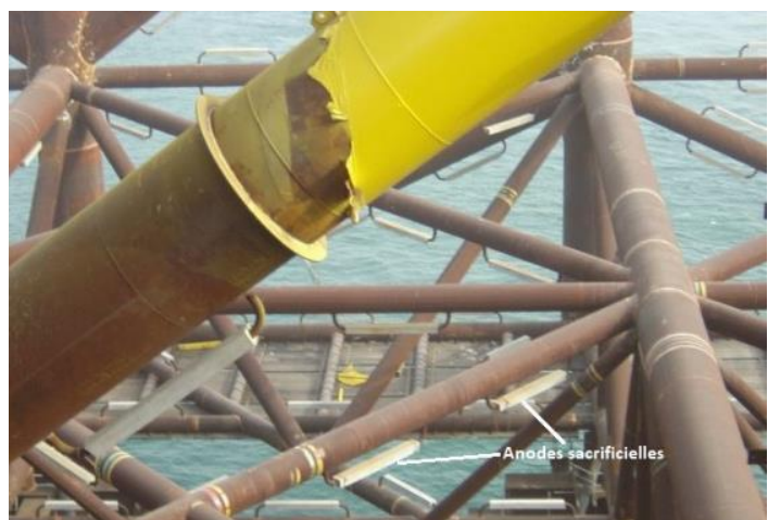
Figure 34: Anodes sacrificielles sur la structure métallique d'une fondation jacket (© Armando-Martin ; Wikimedia commons)
