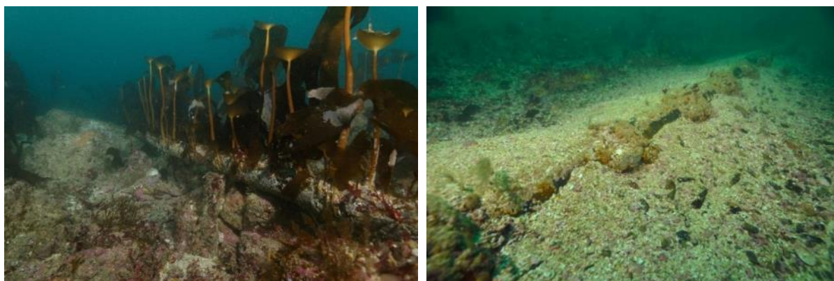
Figure 41 : Colonisation d'un câble électrique de l'hydrolienne Sabella, à Ouessant (Photo de gauche, © Olivier Dugornay) ; Projet pilote hydrolien de Paimpol-Bréhat - Câble électrique de raccordement (point B) (Photo de droite ; © Olivier Dugornay)
